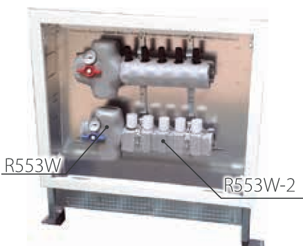
Рисунок 19. Установленный в шкаф коллектор с теплоизолирующими оболочками.
